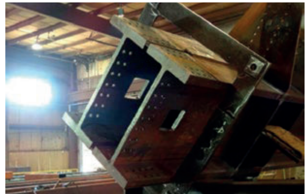
Deux profilés soudés ensemble Two heavy sections welded together Zwei zusammenschweißte Profile
